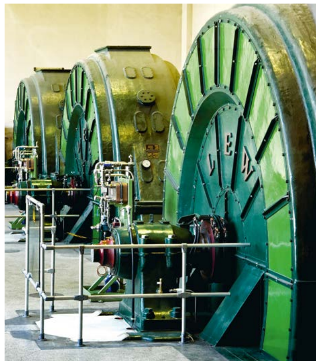
Generatoren von 1922, Kraftwerk in Meitingen
