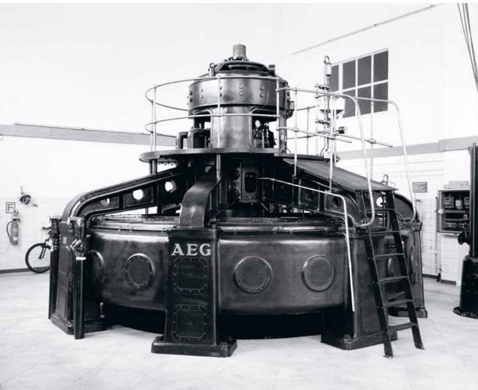
AEG Schirmglockengenerator von 1922, Kraftwerk am Proviantbach
